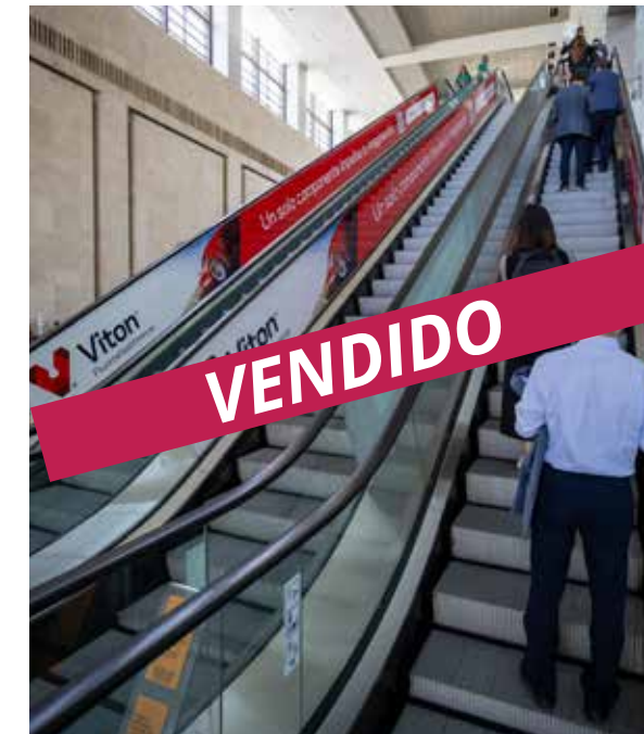
Escaleras eléctricas acceso principal a Centro Banamex (Barandales)
