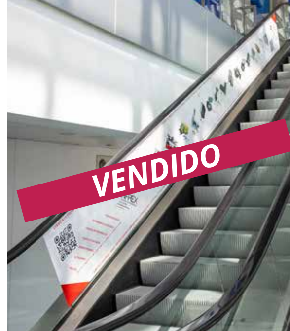
Escaleras eléctricas (Barandales)
